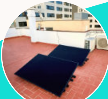
ติดตั้งบนดาดฟ้า
